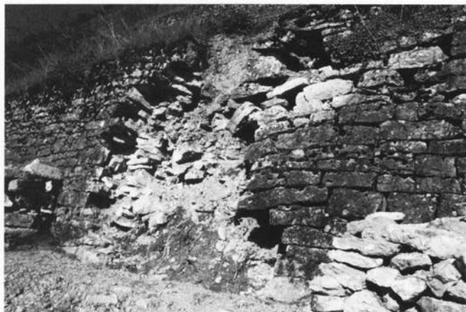
Mauerbresche, zutagetretendes Hangwasser.
