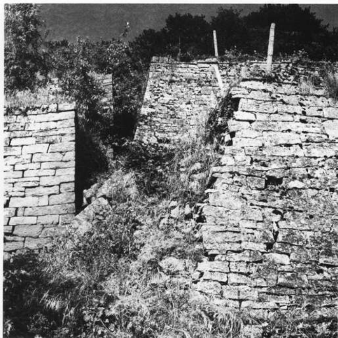
Verwucherte Treppensteige, links intaktes Mauerwerk, rechts eingestürzte Ecke.
