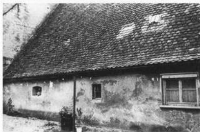
Abb. 9; Hs. Nr. 5, Rückseite. Massive Unterfangung und veränderte Befensterung. Links Stallteil erkennbar. Aufnahme Sept. 1998.
