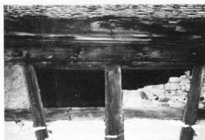
(Bild 5) Das gesamte Gefach ist eingebrochen (September 1991)
