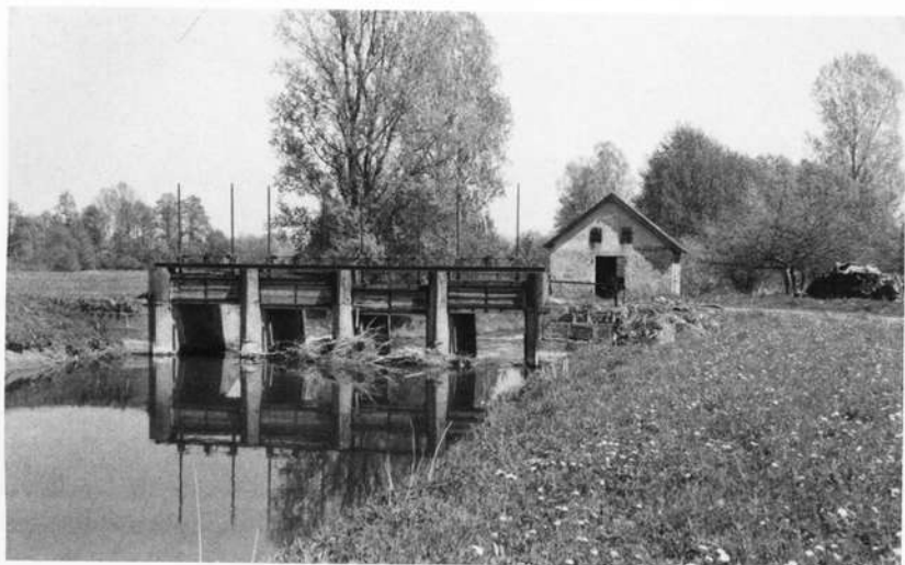
Stauwehr in der Itz südlich von Daschendorf mit Gerätehaus (Frühjahr 1987). Die gußeisernen Installationen wurden von der Firma J. Späth, Nürnberg-Dutzensteich geliefert.
