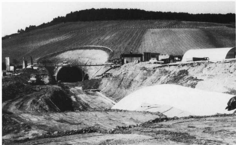
Südportal des 2213 m langen Espenloh-Tunnels der Neubaustrecke Hannover–Würzburg der Deutschen Bundesbahn, in Reb- und Ackerland östlich Oberleinach (Lkr. Würzburg)
